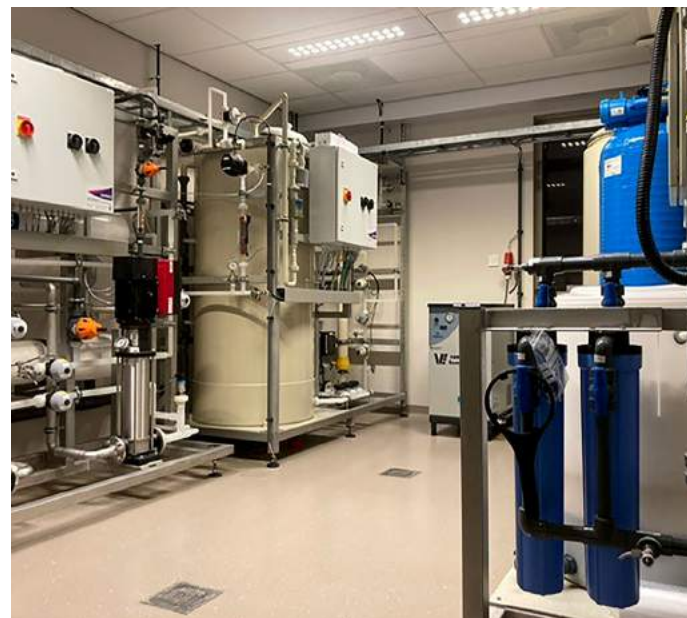
De waterinstallatie in dependance Scheemda
